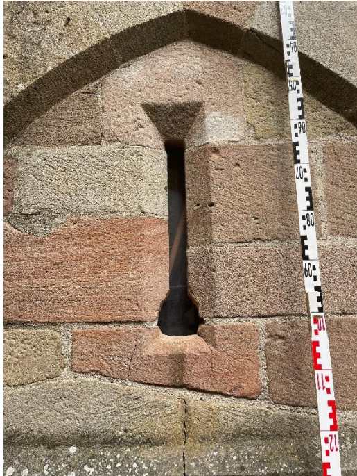
Figure 113. Bouchage et fente au-dessus de la porte de l'entrée à l'ouest du RDC de la façade sud de la maison Fabre. Crédit Florence Guillot.
