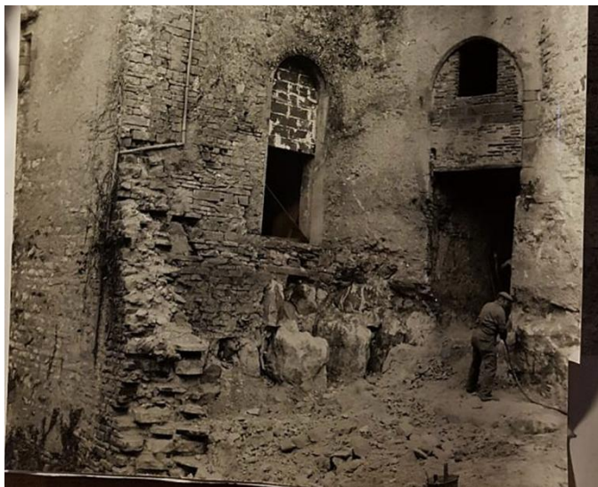
Figure 74. Archives DRAC Toulouse. Dossier des travaux de 1989. Image antérieure à 1989. Ouv160 (à gauche de l'image) et ouv2.
