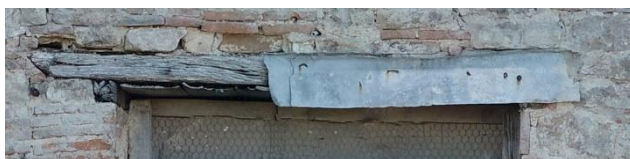
Fig. Linteau en bois et zinc de l'Ouv11, parement externe M1. Extrait de l'orthophotographie de Pascal Robert-Cols
