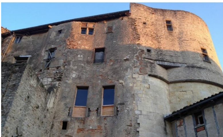
Fig. Façade nord de la maison Fabre, tour nord de la porte des Ormeaux. Festonnement. Crédit Pascal Robert-Col (2021, fig. 110)
